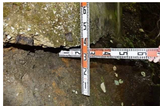
橋台基礎の洗堀
