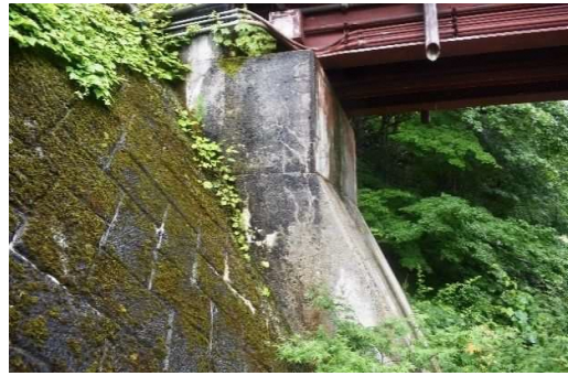
橋台の著しいひびわれ、遊離石灰
