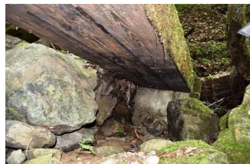
橋台の傾倒、洗堀
