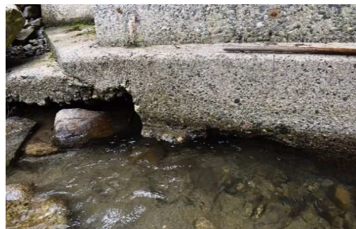
橋台基礎の洗堀
