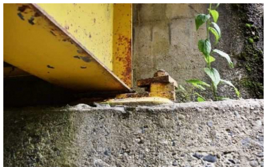
支承の破損による桁端部のずれ
