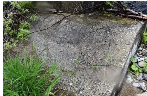
橋台基礎の洗堀
