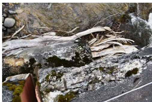
橋台の断面欠損
