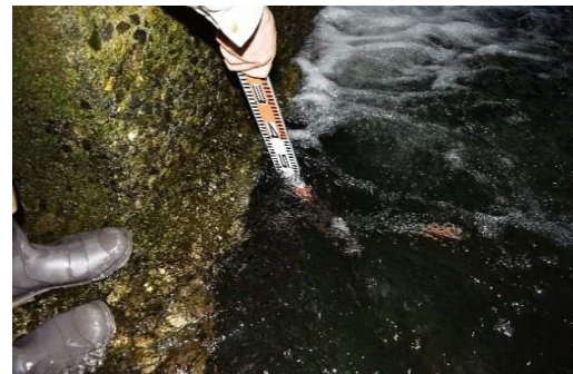
橋台基礎の洗堀
