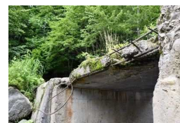
床版の著しい断面欠損、鉄筋露出
