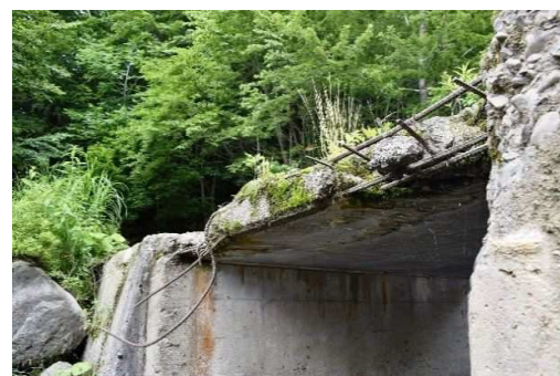
床版の著しい断面欠損、鉄筋露出
