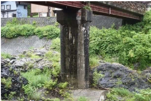
橋脚の著しいひびわれ、遊離石灰
