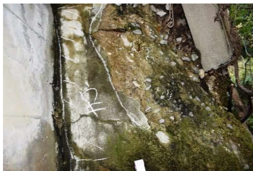
橋台の断面欠損
