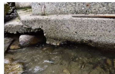
橋台基礎の洗堀
